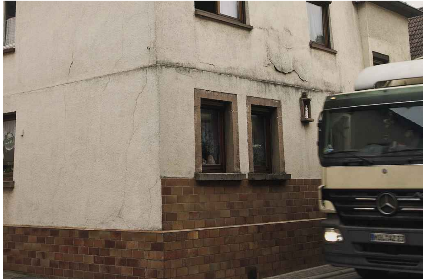
Häuser, die nahe der Straße stehen, haben immer wieder mit Rissen, verursacht durch den Schwerverkehr, zu kämpfen.
