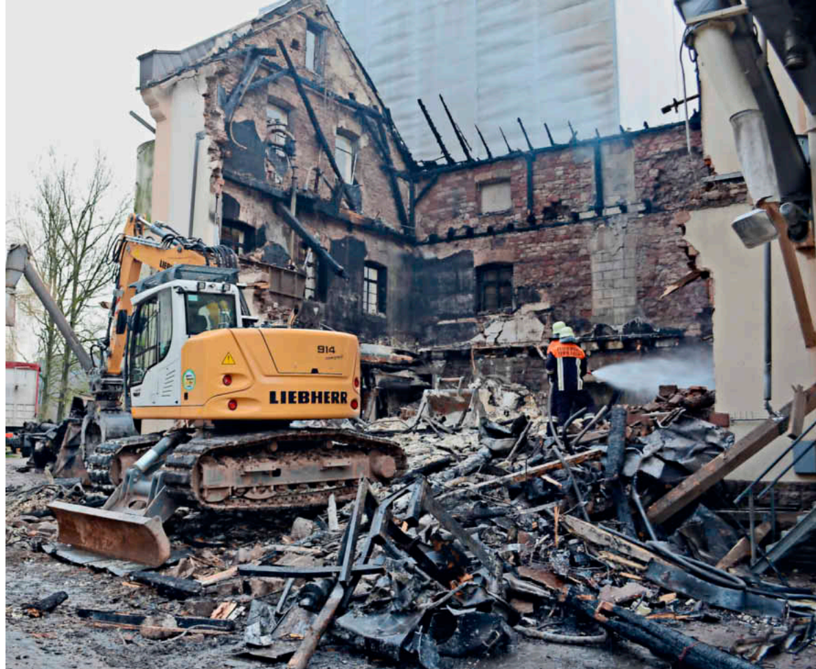
Die Getreidemühle in Eichenbühl ist komplett niedergebrannt. Noch immer sind Glutnester unter den Trümmerteilen versteckt, die gelöscht werden müssen.
