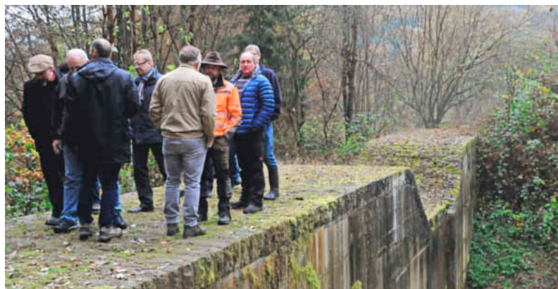
Mauer am Wildbach: Hier wurden nach dem Maiunwetter 500 Kubikmeter Geröll weggeräumt, die ohne Sperre in den Ort gespült worden wären. Foto: Siegmack Ackermann
