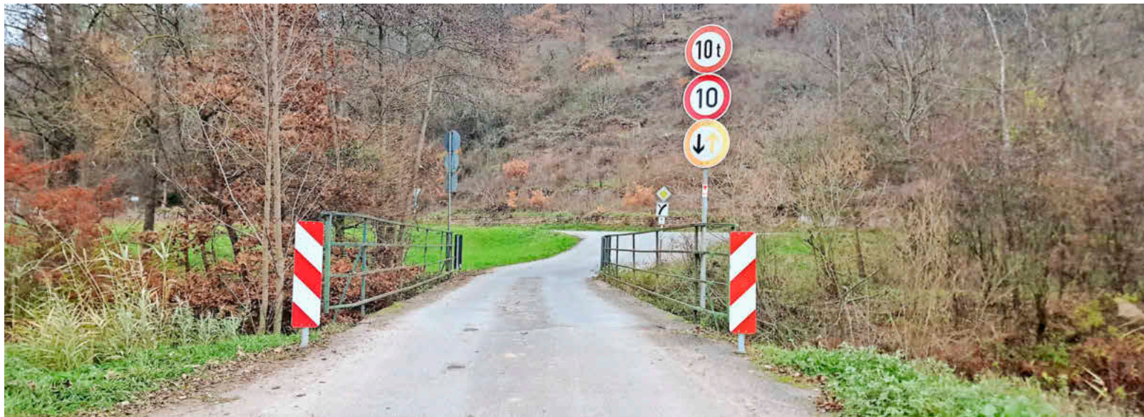
Die Behelfsbrücke am Regenüberlaufbecken ist in die Jahre gekommen.
