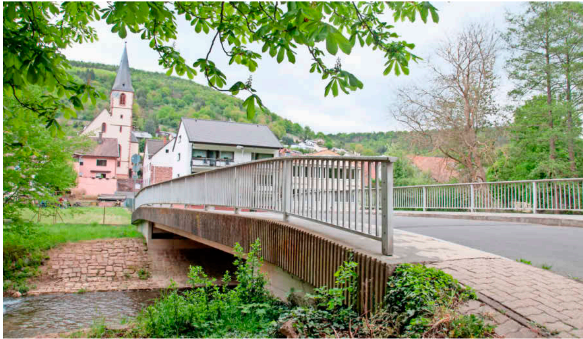
Ein großer Kostenfaktor im Haushalt: Eichenbühls Brücken müssen saniert werden. Für die Pfarrbrücke (im Bild) sind 280000 Euro erforderlich.
