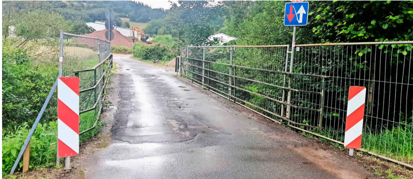
Rohstoffpreise gefährden den Zeit- und Kostenplan für den Neubau der Brücke am Regenüberlaufbecken nahe dem Eichenbühler Tennisheim.
