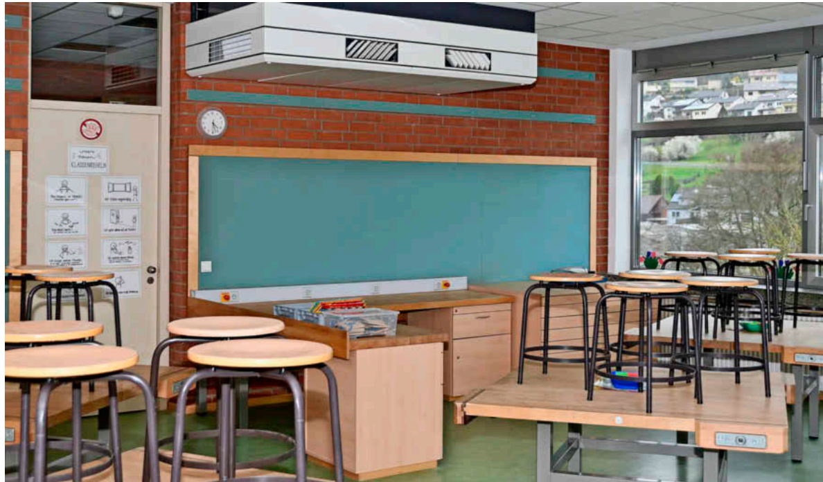
Drei von elf dezentralen Lüftungsanlagen sind in der Erftalgrundschule an der Decke bereits verbaut. Der Rest folgt in den Osterferien. 300.000 von insgesamt 530.000 Euro sind im Haushalt für 2023 dafür eingeplant.
