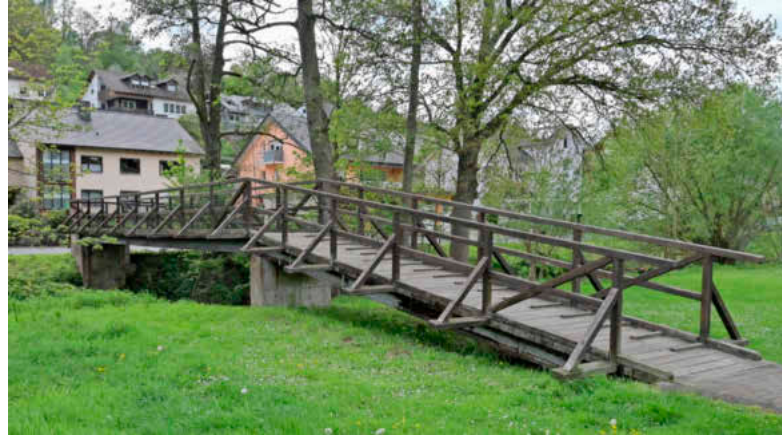
Wegen fortgeschrittener Korrosion an den Stahlträgern als ungenügend bewertet: die Fußgängerbrücke über die Erf beim Dorfplatz. Foto: Siegmар Ackermann
