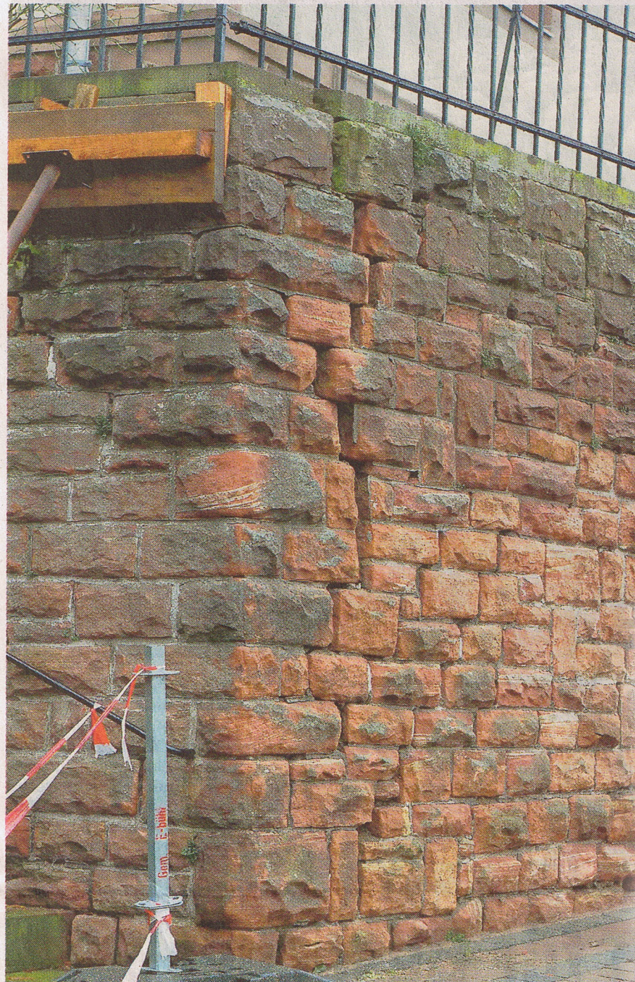
Ein großer Riss zieht sich durch die Stützmauer vor dem Kindergartengebäude in Eichenbühl.
